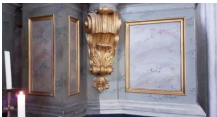
Foto: Probestück, rechts der gereinigte Teil
